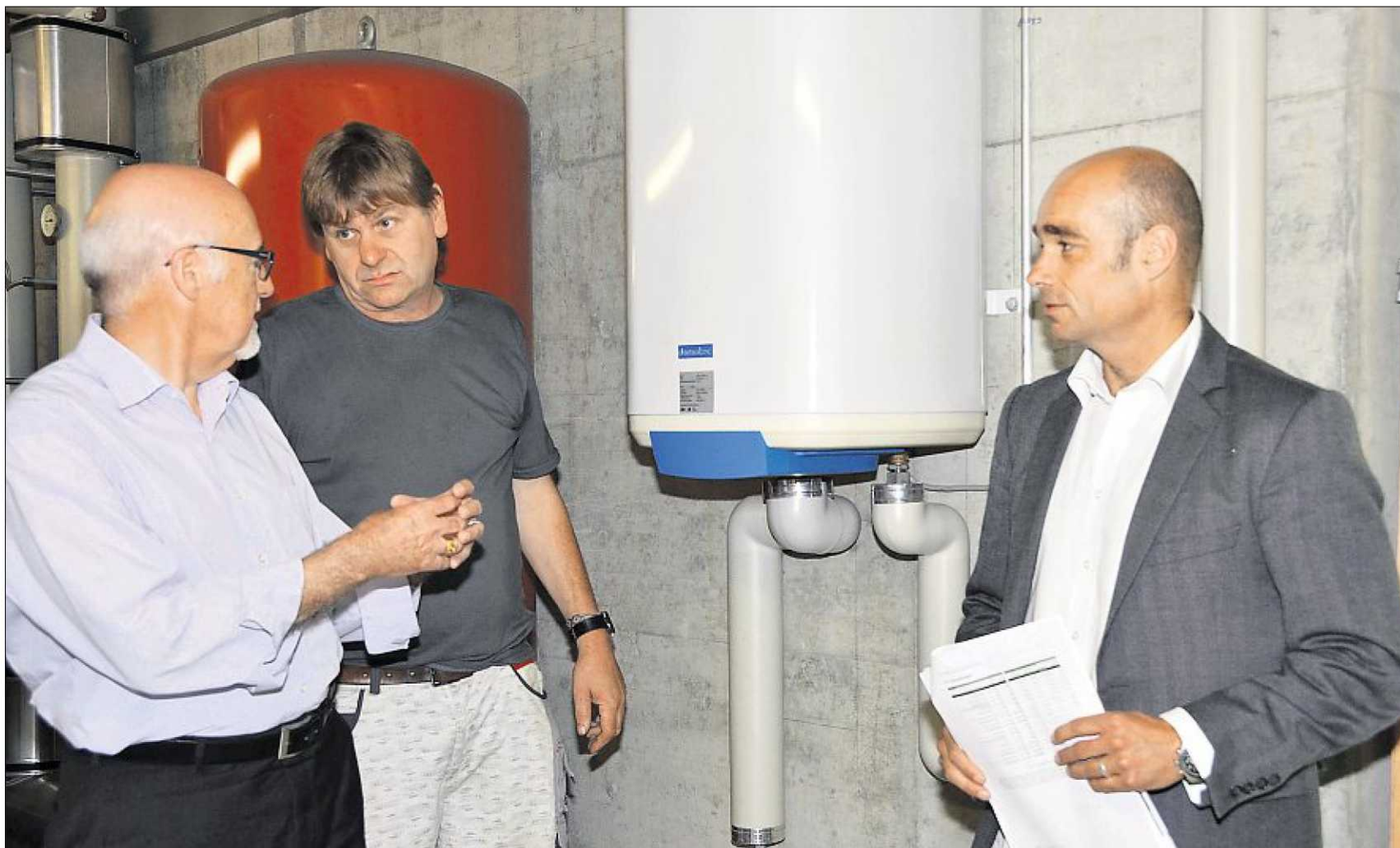
Im Schulhaus Stumpenmatt hat man mit kleinen Anpassungen viel Geld einsparen können, wie sich Hauswart Erwin Bachmann (Mitte) Werner Kälin (EBS, links) und Daniel Hännly (energo) überzeugten.
